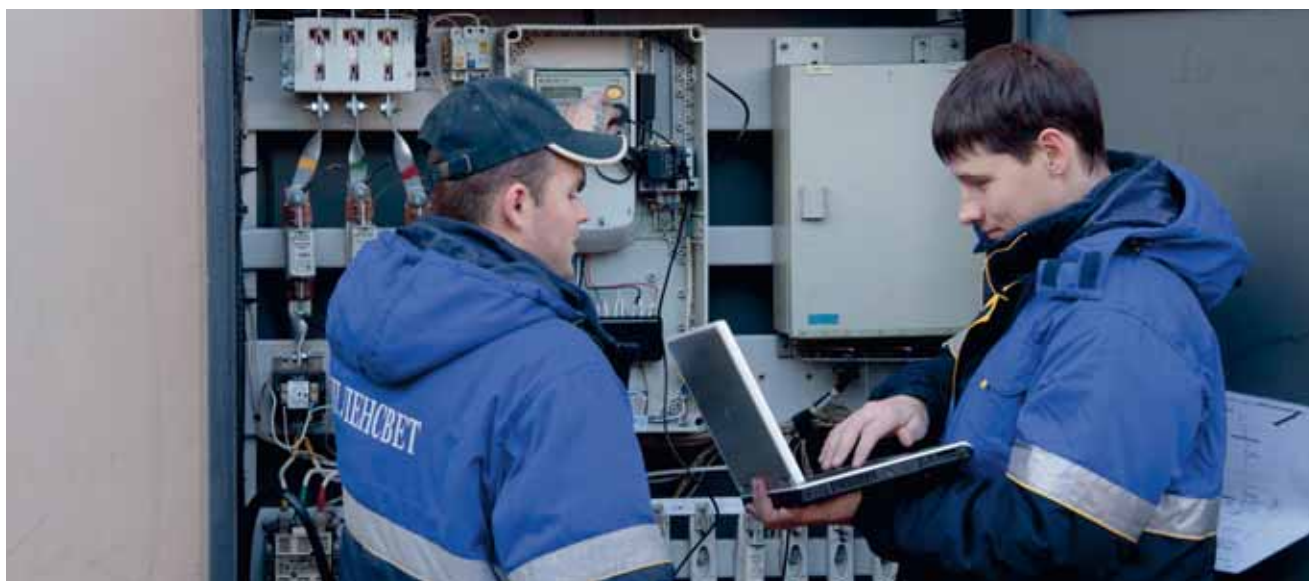
Программирование приборов учета электроэнергии
